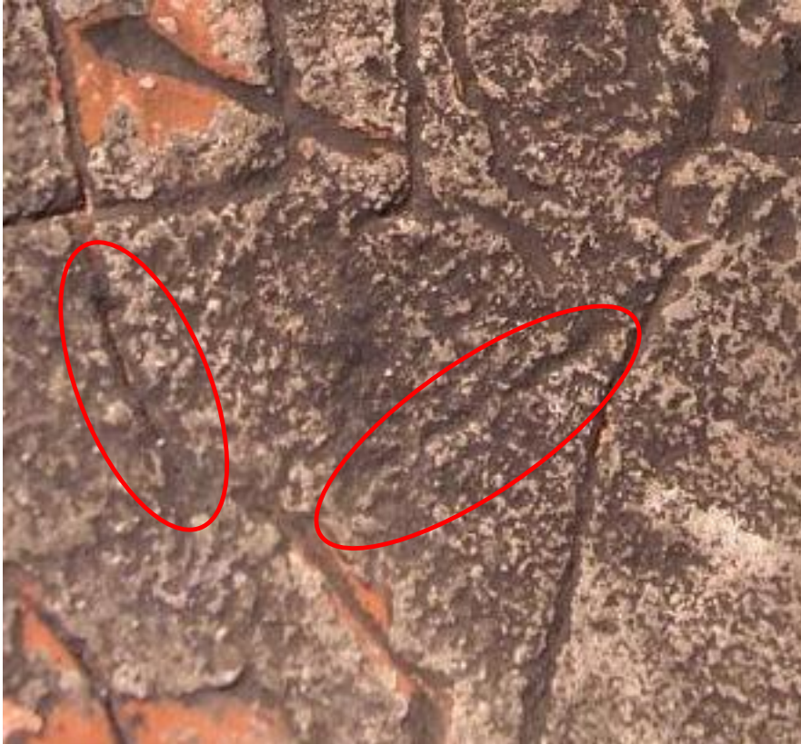
Figura 4. Pieza 5 en la colección de la DFA- no conocemos el número de referencia. Se ve la presencia de una capa negra que suponemos sea hollín, se ven varios surcos parcialmente tapados. /Foto DFA
